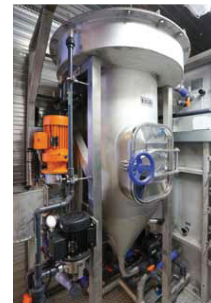
L'« ExSep » intégré dans le module « Box4Water ».
