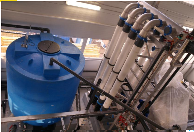
Модуль ультрафильтрационных мембран выносного типа Air-Lift
